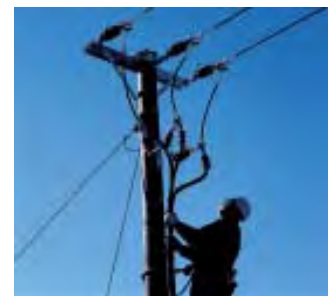
SOT 24 kV, Sweden.
