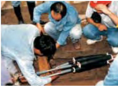
SOJ 12 kV, China.
