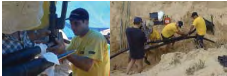
SOJ 24 kV, Portugal.
